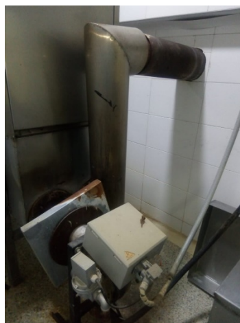
FOTOGRAFIA 4. QUEMADOR DE LA ESCALDADORA
